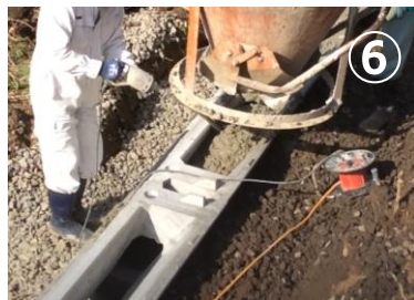
⑥ 所定の段数まで施工完了後、間詰めコンクリートを天端まで打設
